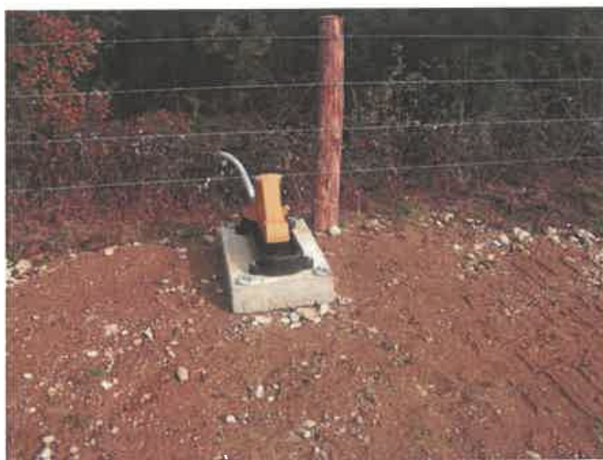
Figure 4 : Photo exemple d'une pompe de prairies dans la maîtrise du piétinement bovin
